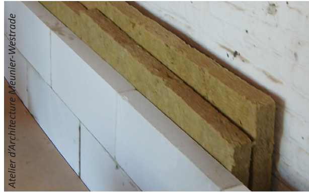
Rouleaux de laine minérale placés entre le mur existant et la nouvelle paroi intérieure constituée de blocs de plâtre.
