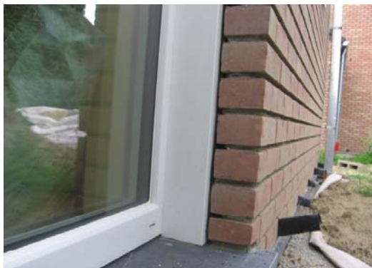
Raccord entre châssis et maçonnerie : photo de la réalisation (on visualise le caisson PVC abritant le retour d'isolant devant le dormant du châssis) (source PMP)
